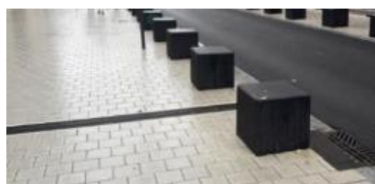
À gauche : Quartier Beauregard (Rennes) : Caniveau gargouille sur trottoir Rue Plélo (Rennes) : Caniveau gargouille à ciel ouvert sur trottoir
